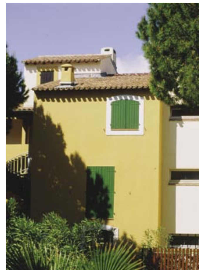
Les façades des maisons sont agressées par le temps qui passe et les intempéries. (Seigneurie)
