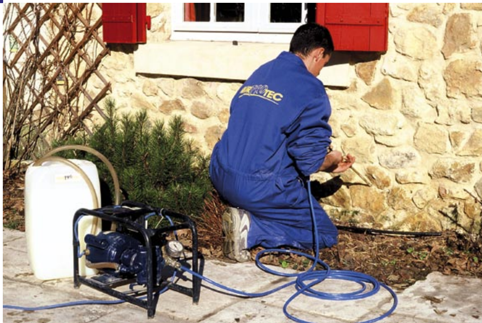
Le traitement de l'humidité requiert souvent des techniques et des compétences professionnelles (MurProtec).
